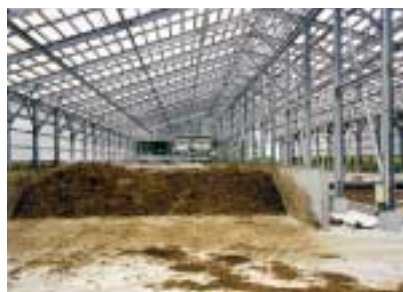
たい肥化設備(発酵槽)
