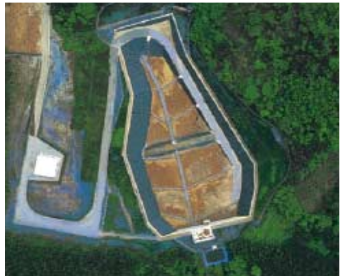
最終処分場浸出水処理設備
