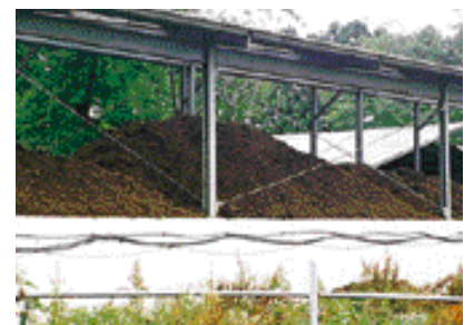
たい肥化設備(後処理舎)
