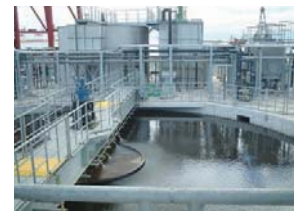
排水処理設備
